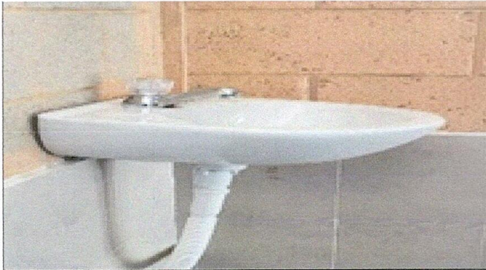
Foto1: Lavamanos instalado en los baños
