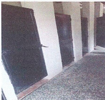
PUERAS DE SANITARIO PINTADAS
