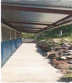
Foto 1. Plataforma de concreto en la parte posterior de dos aulas por derrumbe e inundación en época de invierno.
