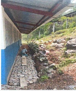
Foto 1. Plataforma de concreto en la parte posterior de dos aulas por derrumbe e inundación en época de invierno.
