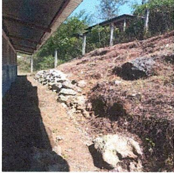
Foto 1. Plataforma de concreto en la parte posterior de dos aulas por derrumbe e inundación en época de invierno.
