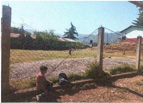
Foto 3. Reparación de muro perimetral con hiladas de block, tubos galvanizados y malla metálica.
