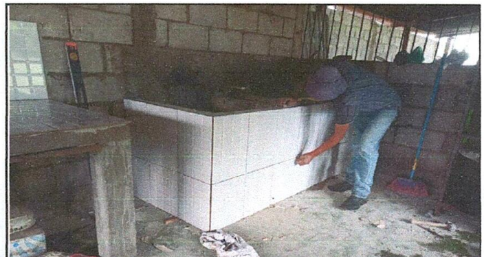
Foto 4: Puede apreciarse que a la pila y la mesa de concreto de la cocina del establecimiento se le está colocando el azulejo respectivo.
