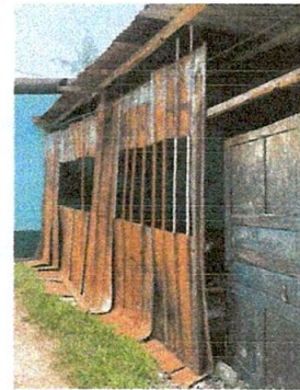
Foto 4: Sustrucción de estructura de madera por estructura de metal y lamina troquelada calibre 26
