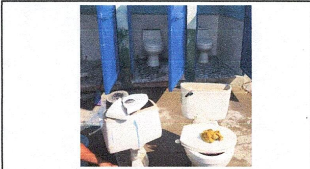
Foto16: Mejoramiento de Baños con azulejos, cambio de accesorios y sustitución de taza.
