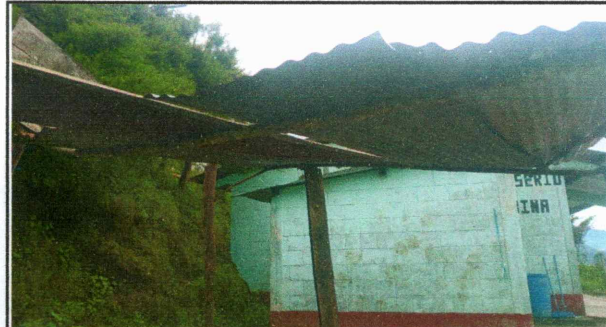
Foto 2: Sustrición de soporte de estructura de madera por metal
