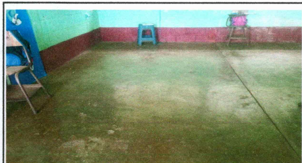
Foto 4: Sustrición de piso de granito
