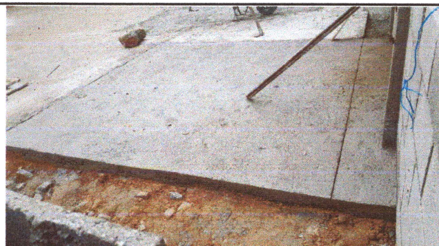
Foto 4. Torta de cemento de 3 metros por 4
