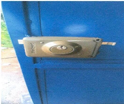
Foto 5: Cambio de chapas para puertas de aulas
