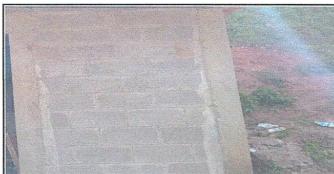
Foto 5: paredes de baños
