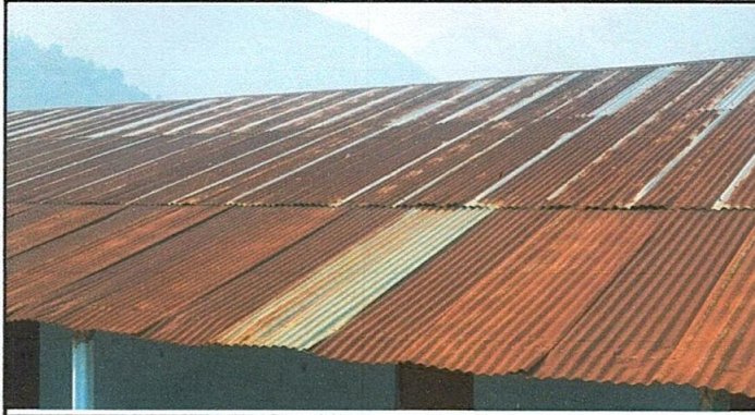
Foto 1: lámina en malas condiciones
