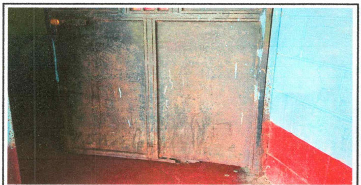
Foto 1: puerta de direccion en mal estado
