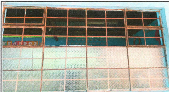
Foto1: ventana con vidrios rotos, vista exterior
