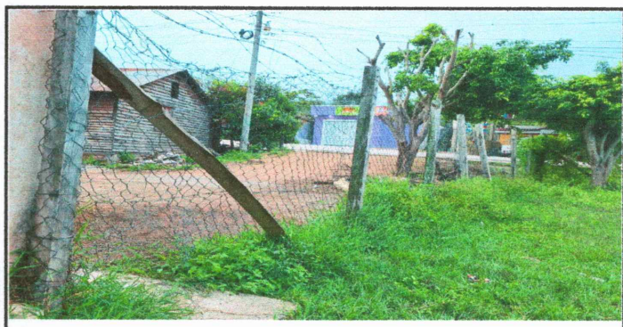
Foto 6: muro perimetral, malla en mal estado
