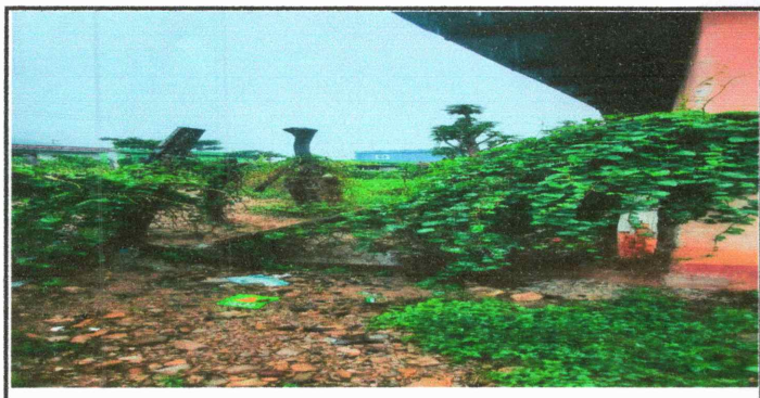
Foto 5: muro perimetral, malla en mal estado
