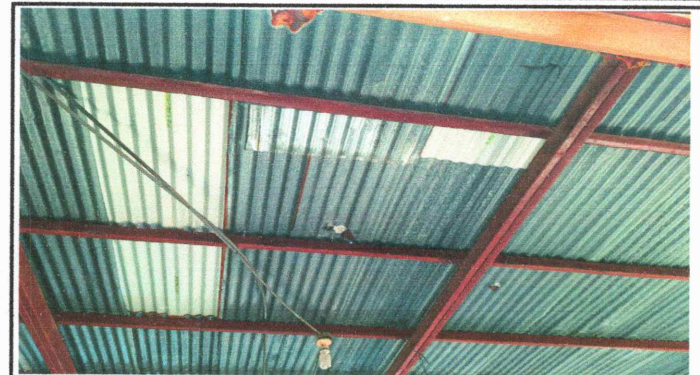
Foto 2: vista interior del aula con techo roto
