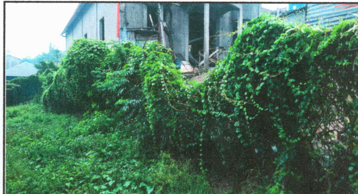
Foto 4: muro perimetral, malla en mal estado
