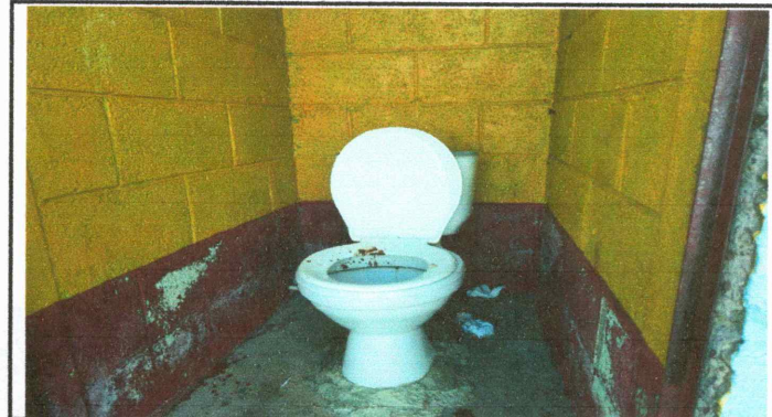
Foto 2: inodoro en mal estado
