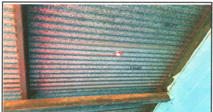
Foto 3: vista interior del aula con techo roto
