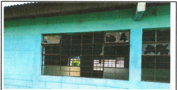
Foto 4: ventana con vidrios rotos
