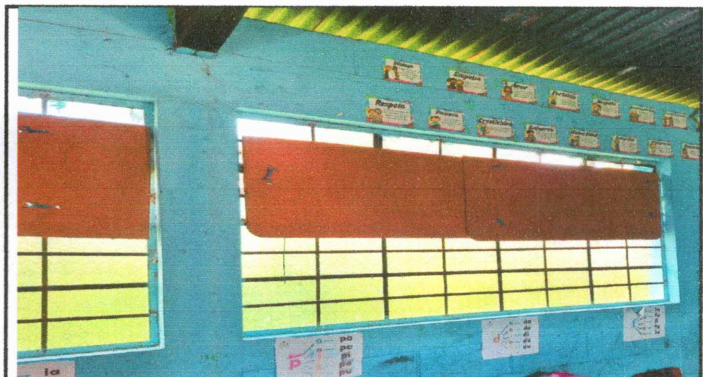
Foto2: ventana con vidrios rotos, vista interior
