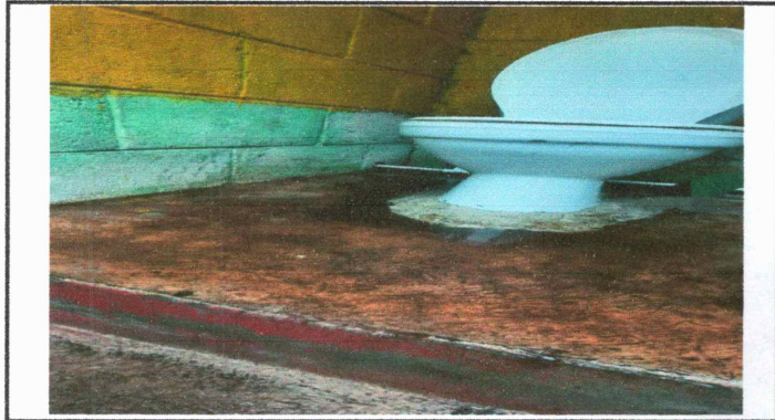
Foto 3: fuga en inodoro
