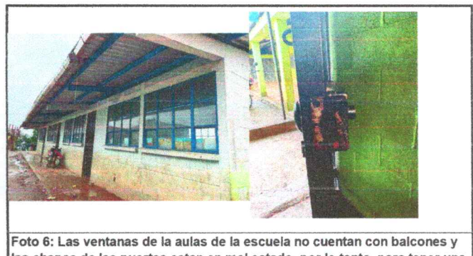
Foto 6: Las ventanas de la aulas de la escuela no cuentan con balcones y las chapas de las puertas están en mal estado, por lo tanto, para tener una mejor seguridad es necesario la colocación de balcones en las aulas y cambio de chapas en dos puertas
