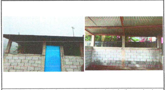
Foto1: El techo de la cocina se encuentra en mal estado, tiene reglas de madera, por lo que se tiene contemplado la reparación con costaneras y sustitución de laminas del techo de la cocina
