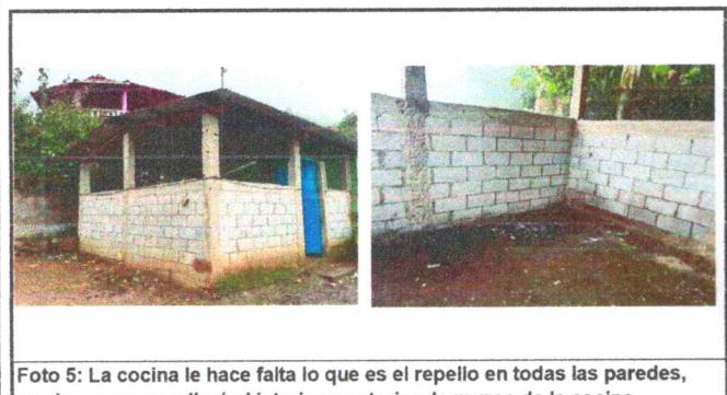
Foto 5: La cocina le hace falta lo que es el repello en todas las paredes, por lo que se repellará el interior y exterior de muros de la cocina
