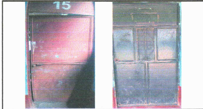
Foto 1: Puertas de metal en mal estado.
