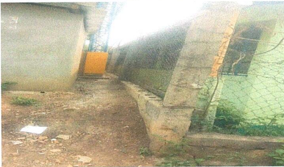
Foto 3 Circulación en mal estado.
