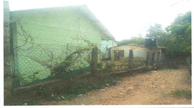
Foto 2 Circulación en mal estado.
