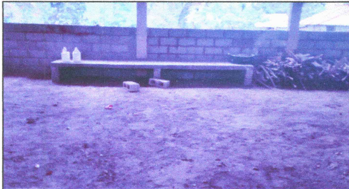
Foto1: Remozamiento para la cocina a la cual se aplicará una sustitucion de piso de torta de concreto, Sustitución de pila de cemento de un lavadero, Sustitución de plancha de metal de 3 hornillas
