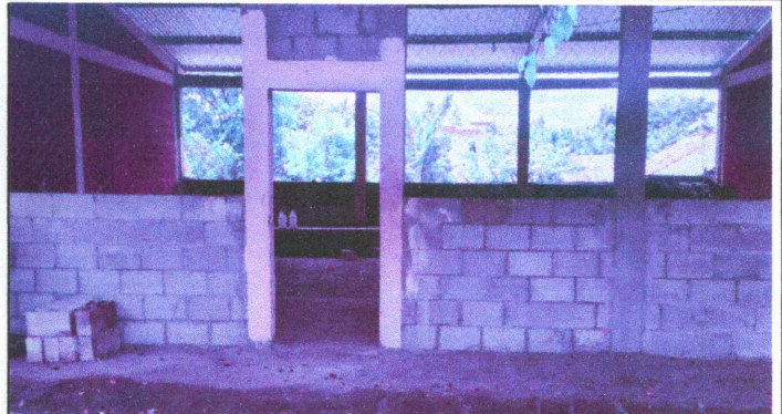
Foto 2: a la cocina se le aplicará Sustitución de puerta, Pintura en muros exteriores e interiores
