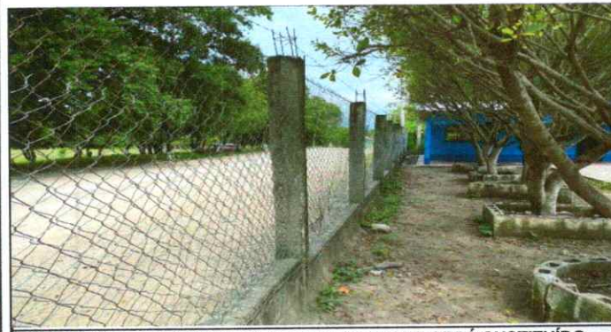
FOTO 11: MURO PERIMETRAL DE 47 M X 2 M QUE SERÁ SUSTITUIDO CON BLOCK, POSTES DE CEMENTO Y MALLA
