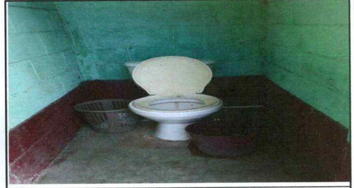
FOTO 10: INODOROS QUE SE ENCUENTRAN EN MALAS CONDICIONES Y SERÁN SUSTITUIDOS
