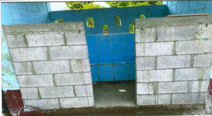
FOTO 13: MINGITORIO CON PISO DE TORTA DE CEMENTO, SE LE COLOCARÁ PISO CERÁMICO
