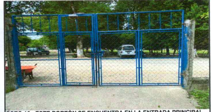
FOTO 12: ESTE PORTÓN SE ENCUENTRA EN LA ENTRADA PRINCIPAL DE ACCESO AL CENTRO EUCATIVO; SERÁ SUSTITUIDO E INSTALADO EN OTRO PUNTO DE LA CIRCULACIÓN PERIMETRAL
