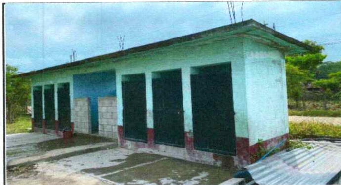
FOTO 9: MUROS INTERIORES Y EXTERIORES DE LOS SERVICIOS SANITARIOS QUE CONSTAN DE 7 AMBIENTES A LOS QUE SE LES APLICARÁ PINTURA
