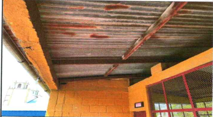
FOTO 1: LÁMINA DETERIORADA QUE SERÁ SUSTITUIDA POR LÁMINA TROQUELADA CALIBRE 26
