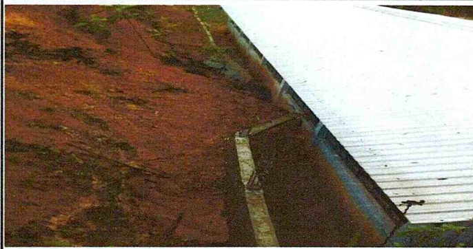
Foto 1: Muro de Contención en malas condiciones
