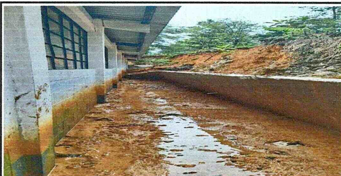
Foto 5: Muro de contención en malas condiciones
