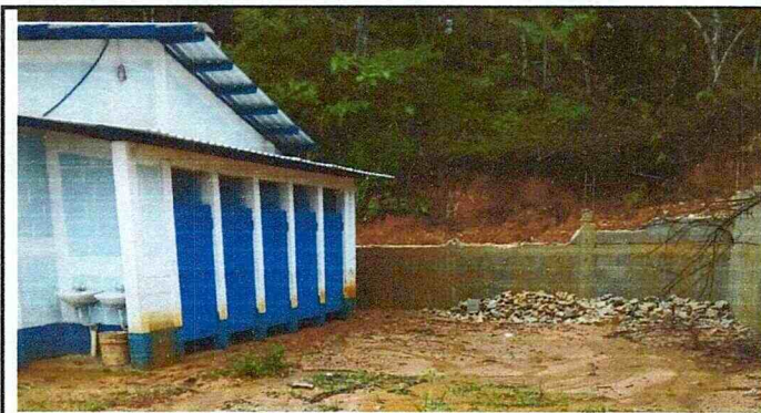
Foto 3: Muro de Contención en malas condiciones.
