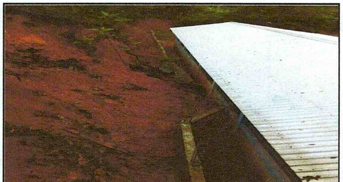
Foto 4: Muro de contención en malas condiciones-
