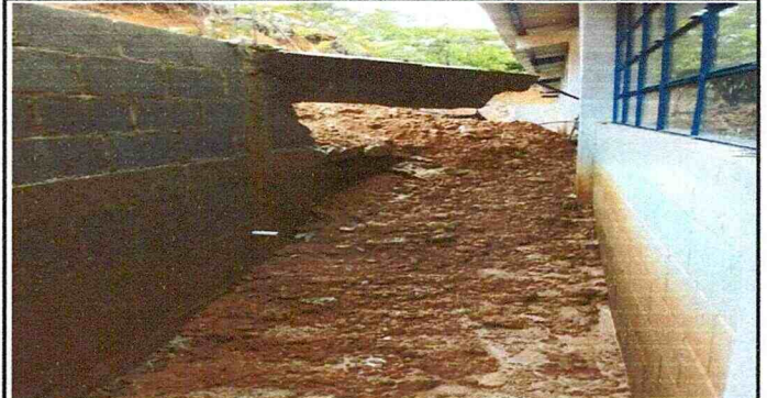
Foto 2. Muro de Contención en malas condiciones.
