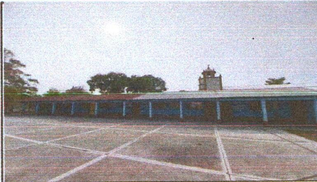
FOTO 1: se sustituirá lámina existente por lámina troquelada calibre 26 en 5 aulas y la Dirección del centro educativo.
