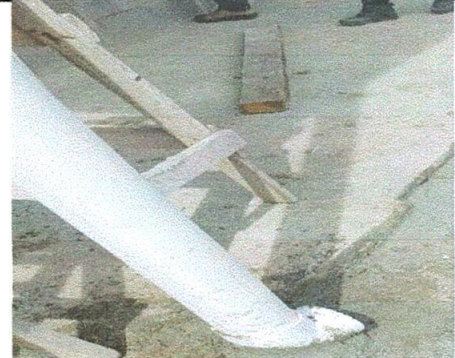
Foto 4: CANALES Y BAJADA DE AGUA PLUVIAL
