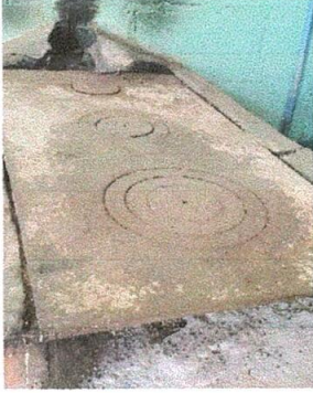
FOTO 7: SUSTITUCIÓN PLANCHA DE 3 HORNILAS
