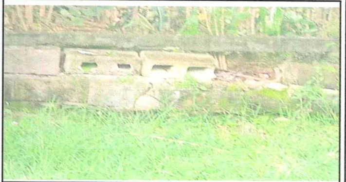
Foto 4: Muro perimetral deteriorado
