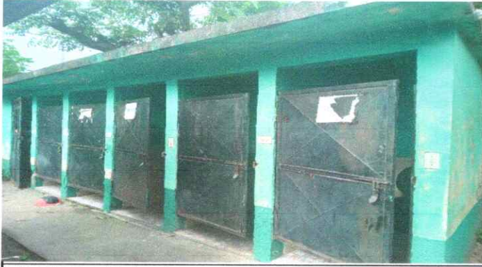
fotoF 1: Puertas deterioradas
