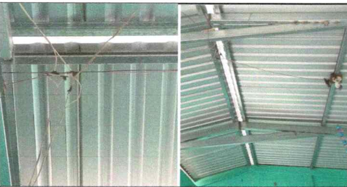
Foto 5: Red de electricidad en mal estado
