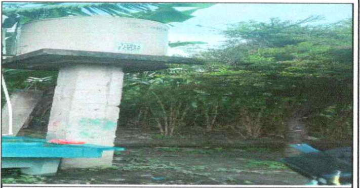
Foto 6: Rotoplast y pila en mal estado
