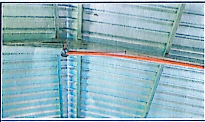
Foto 5: tendido eléctrico en malas condiciones
