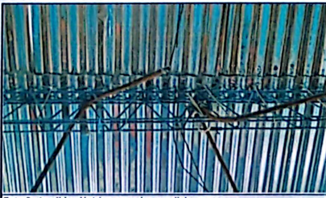
Foto 5: tendido eléctrico en malas condiciones
