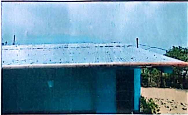
Foto 1: Lámina, estructura en malas condiciones
