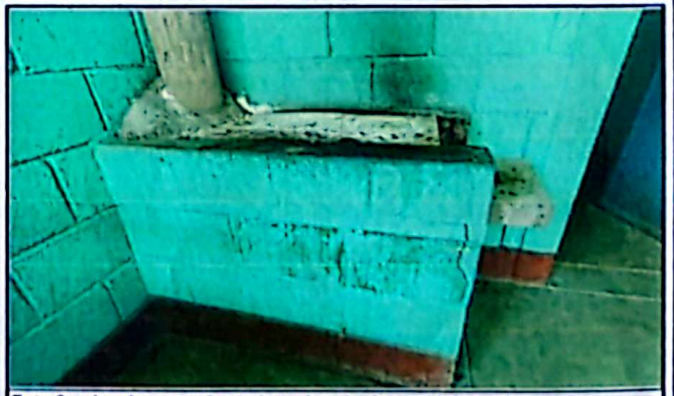
Foto 6: plancha en mal estado y pintado de pared de cocina
