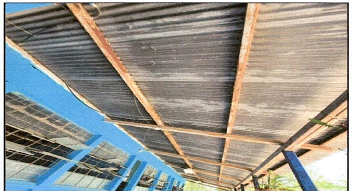
Foto 4: soportes de metal oxidados y picados
