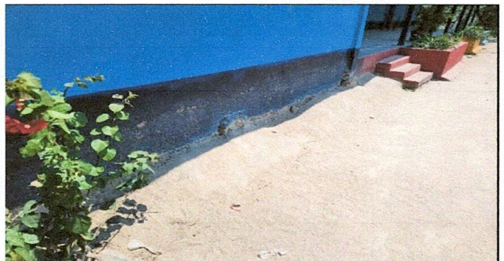
Foto 6: banquetas y gradas faltantes y quebradas.
