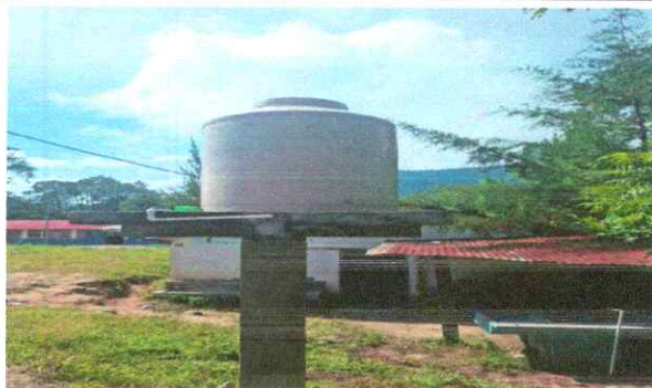
Foto 5: Rotoplast en mal estado
