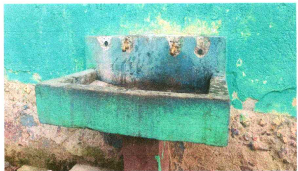
Foto 6: Lavamanos: deterioro y carencia de chorros en el lavamanos
