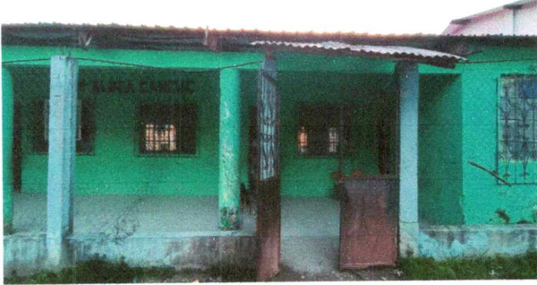
Foto 7: Porton: deterioro de porton
