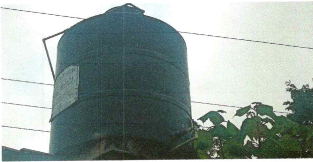
Foto 9: Deposito de agua: Se encuentra en mal estado con varios agujeros.
