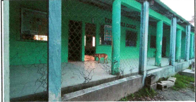
Foto 8: Circulado: el circulado presenta deterioro de la maya
