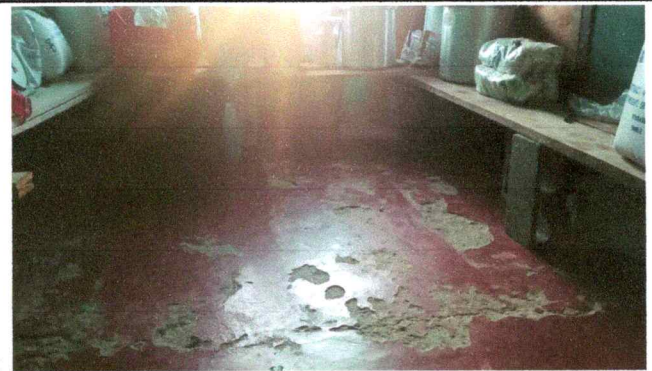
Foto 4: Pisos: agrietamiento en el piso rustico
