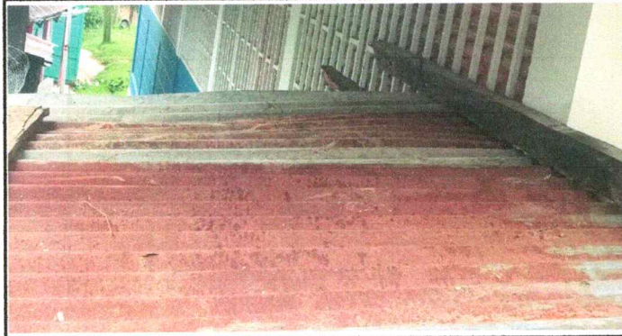
Foto 1: Lámina: la lamina se encuentra en mal estado oxidada y con agujeros
