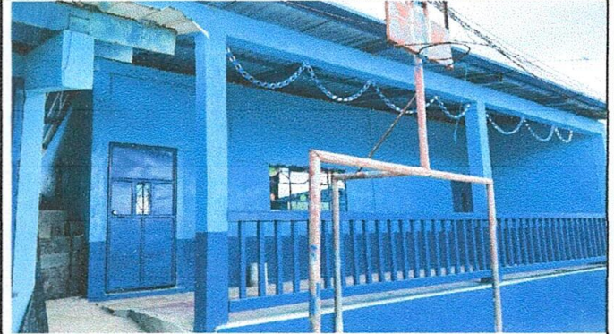
Foto 2: ventanas en mal estado.
