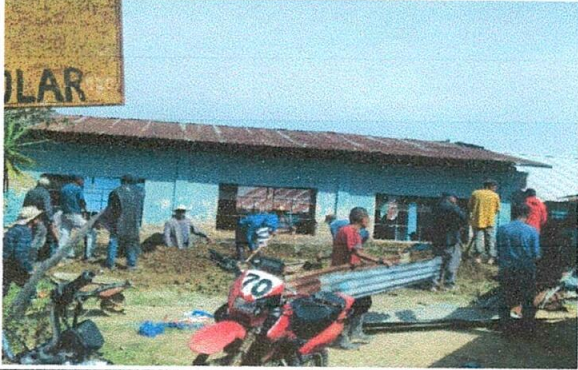
Foto 1: techo y ventanas en mal estado.
