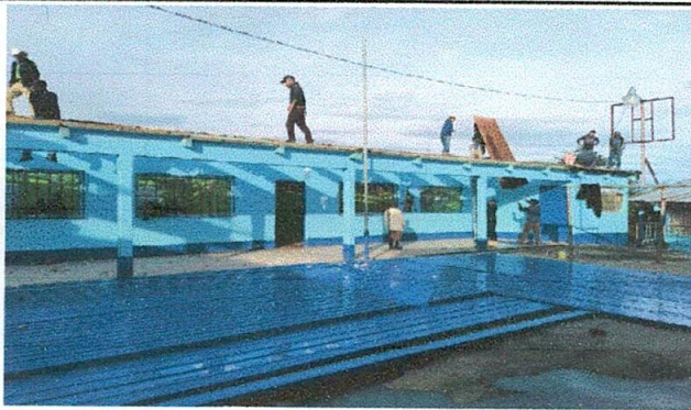
Foto 3: techo en mal estado para remozar.
