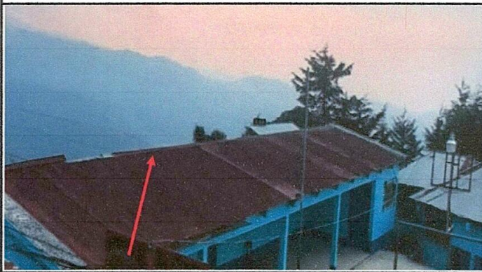
Foto No. 3. Techo en mal estado para remozar.
