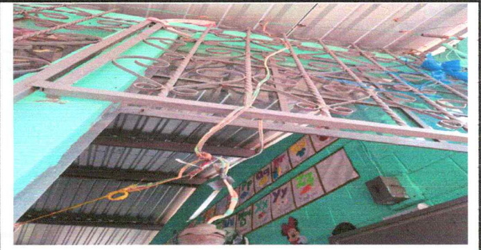
Foto 6: Instalaciones de eEnergia electrica
