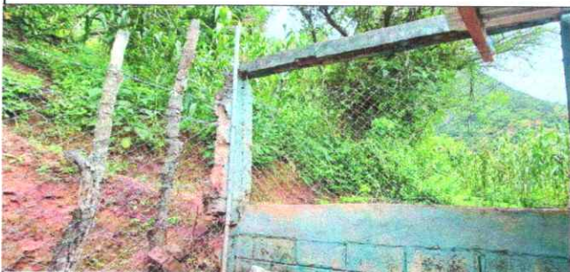
Foto 5: muro perimetral colapsado
