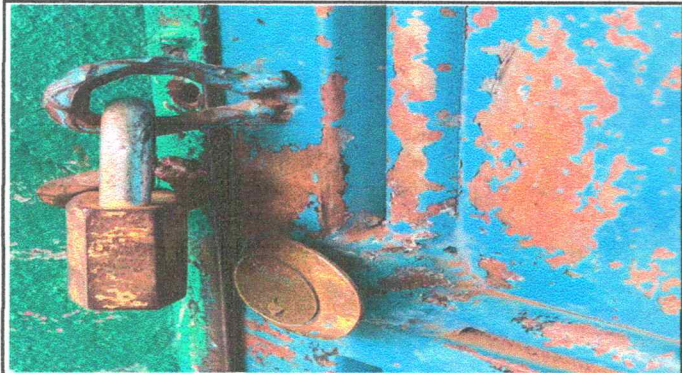
Foto 3: Deterioro y desperfecto de chapas
