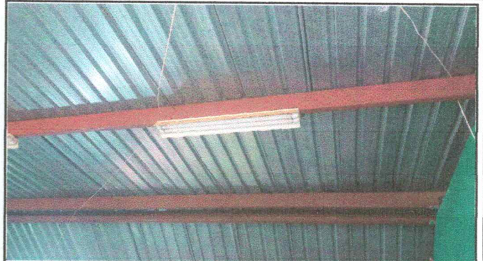
Foto 2: Oxidación y deterioro de costaneras
