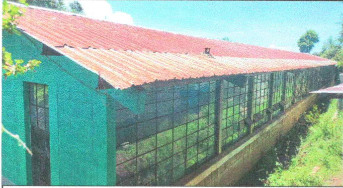
Foto1: Deterioro y perforación de lámina y capotes.
