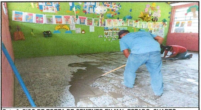
Foto 6: PISO DE TORTA DE CEMENTO EN MAL ESTADO, CUARTO GRADO.
