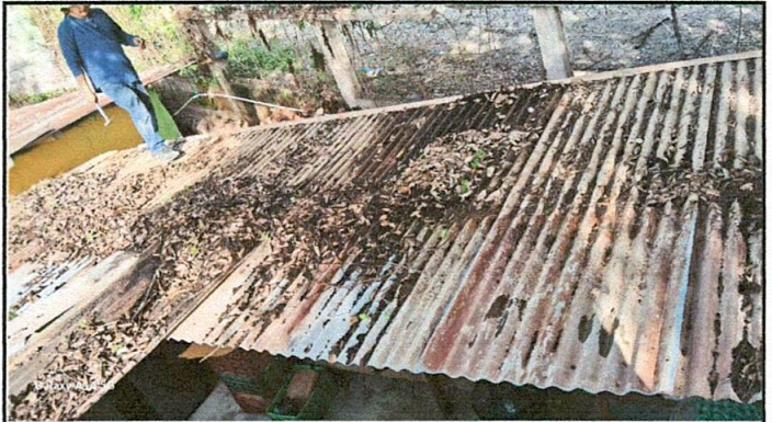
Foto 2: BODEGA: ESTRUCTURA DE MADERA EN MAL ESTADO.
