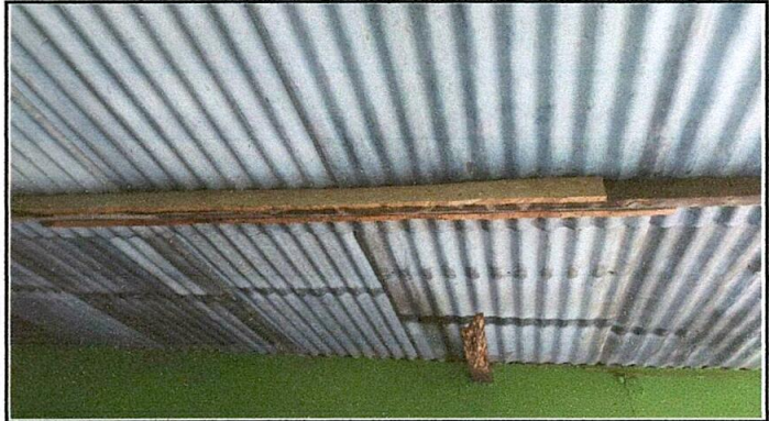
Foto 2: BODEGA: ESTRUCTURA DE MADERA EN MAL ESTADO.
