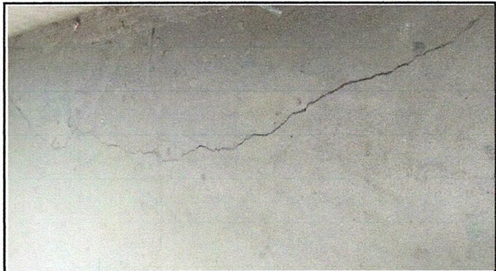
Foto 4: PISO DE TORTA DE CEMENTO EN MAL ESTADO, SEGUNDO GRADO.
