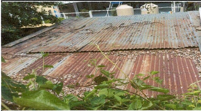
Foto 1: BODEGA: CUBIERTA DE LÁMINA EN MAL ESTADO.
