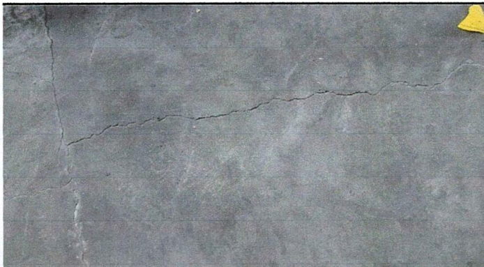
Foto 3: PISO DE TORTA DE CEMENTO EN MAL ESTADO, PRIMER GRADO
