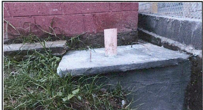
Foto 4: Línea principal de aguas negras y cajas de registro
