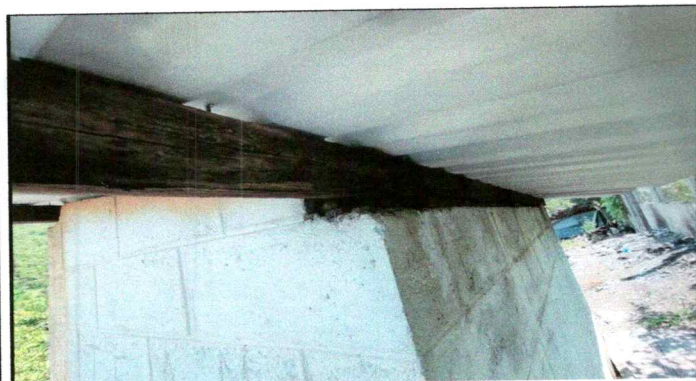
Foto 3: Estructura del techo de baños de madera, deteriorada por antigüedad.
