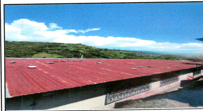
Foto 5: Láminas dañadas o en malas condiciones del techo de aulas.
