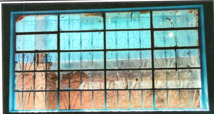
Foto 7: Vidrios quebrados y en mal estado de ventanas de aulas.
