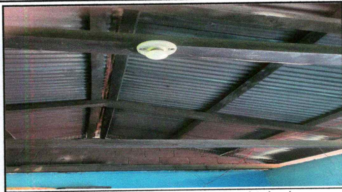
Foto 2: Estructura del techo de la cocina de madera, deteriorada por antigüedad.
