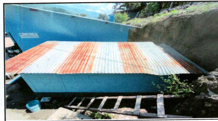
Foto 4: Láminas dañadas o en malas condiciones de los baños.
