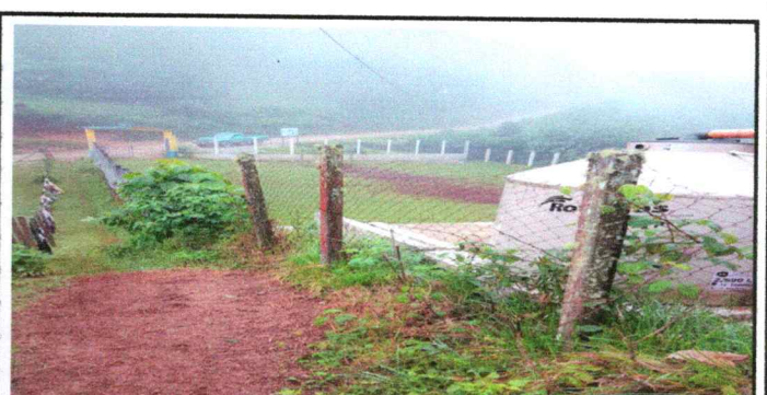
Foto 6: En mal estado el muro perimetral y deposito de agua
