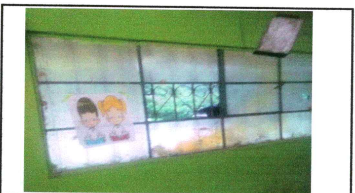
Foto 4: Ventanas en mal estado
