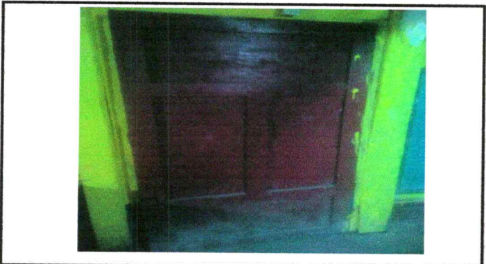
Foto 3: Puertas en mal estado
