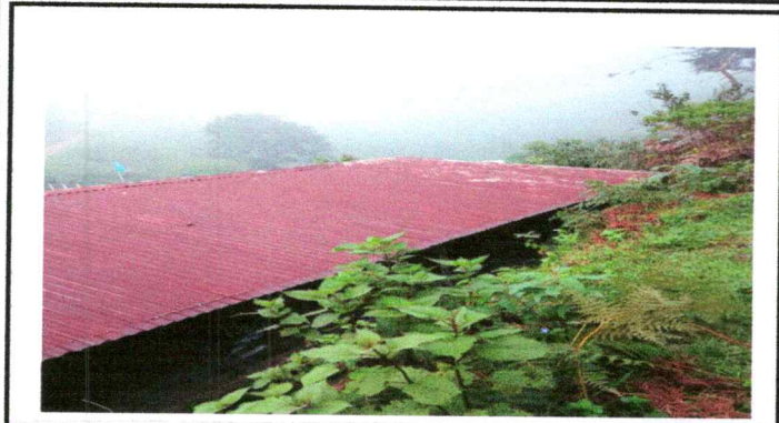
Foto 1: Lamina en mal estado
