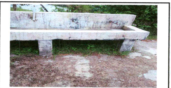
Foto 5: Piso en mal estado
