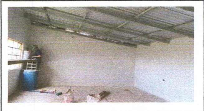
Foto 4: madera de soporte en malas condiciones
