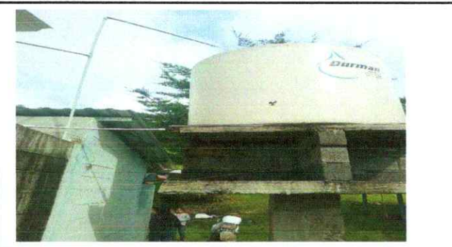
Foto 6: Depósito de agua
