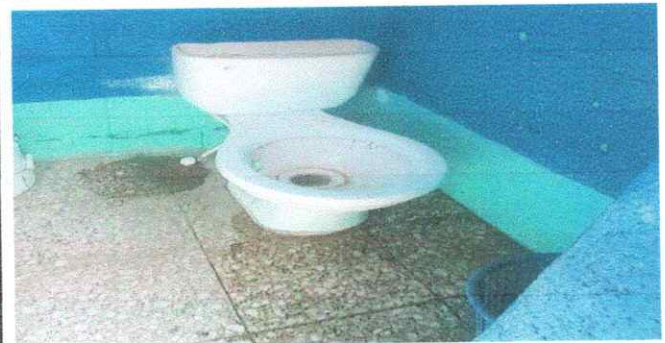
Foto 4: Inodoros en muy mal estado.
