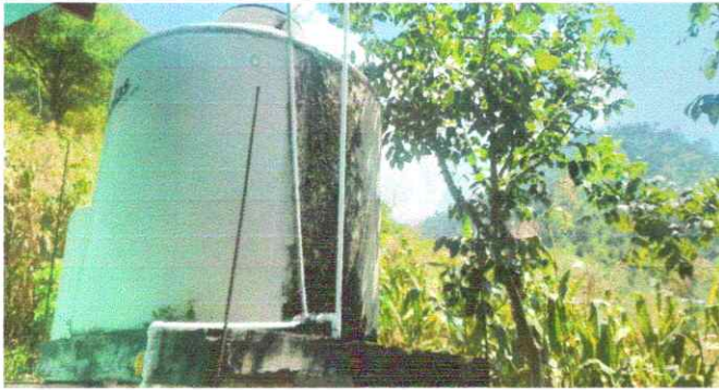
Foto 7: Deposito de agua en muy mal estado.
