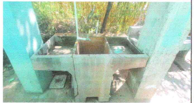
Foto 2: Pila de dos lavaderos deteriorada.
