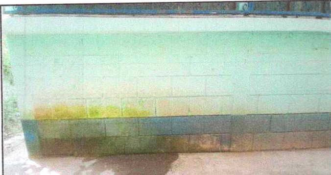
Foto 3: Pintura en deterioro
