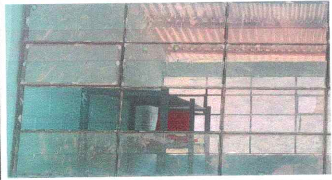
Foto 2: Daños en las ventanas.
