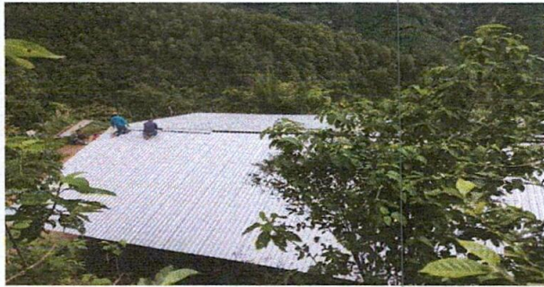
Foto1: lamina en malas condiciones
