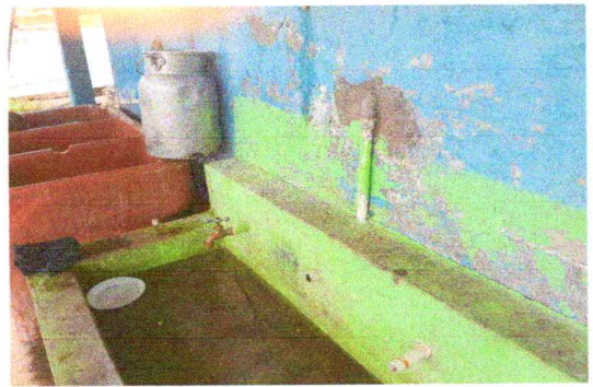
Foto 16: Sustrucción de llaves de chorro
