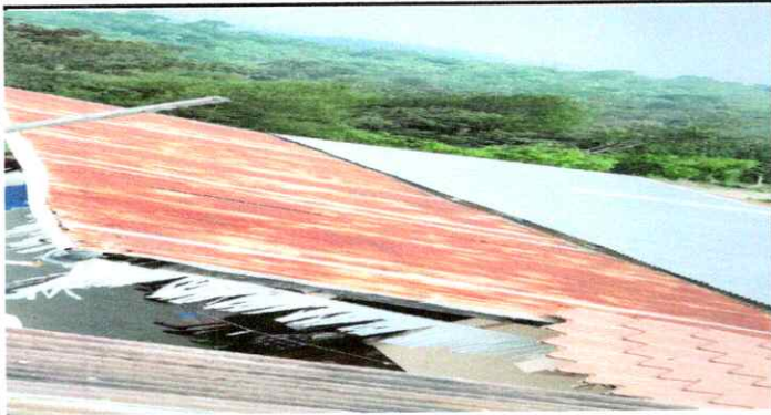
Foto1: Lámina en mal estado
