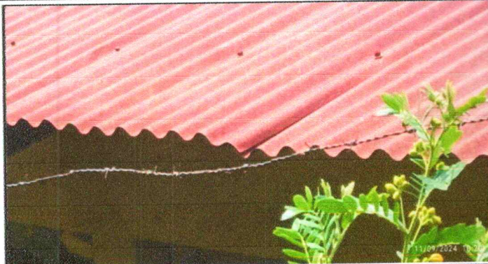
Foto 1: Lámina en mal estado a sustituir
