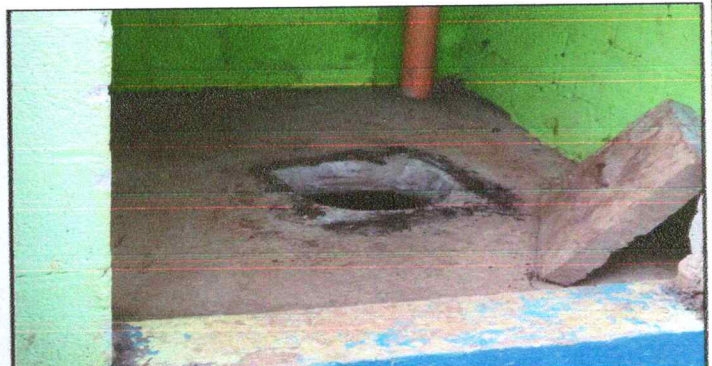
Foto 6: Sanitario en malas condiciones
