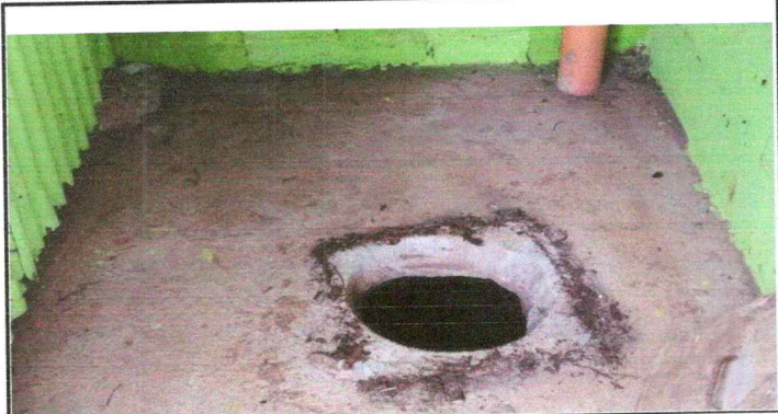
Foto1: Baños en malas condiciones
