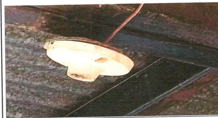
Foto 5: Electricidad y estructura de soporte
