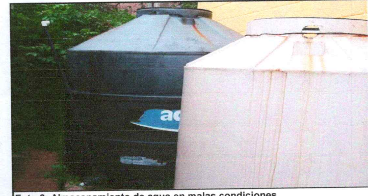
Foto 6: Almacenamiento de agua en malas condiciones
