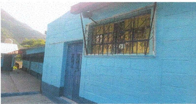
Foto 5: Pintura de aula en la parte exterior
