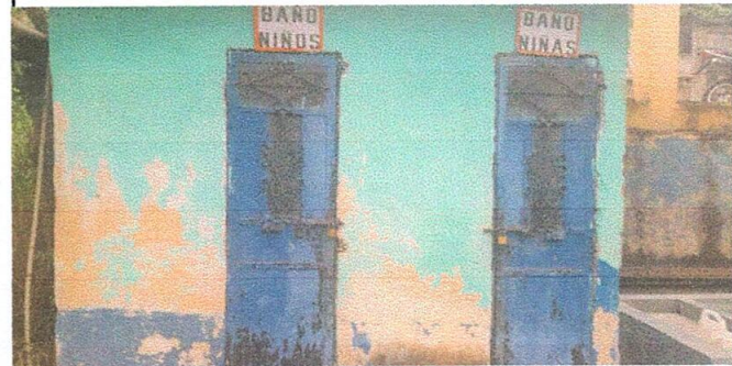
Foto 6: Pintura de baños en mal estado.
