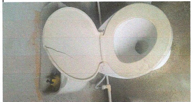
Foto 4: Baños en mal estado
