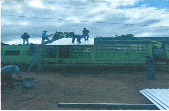
Foto1: Lámina y estructura dura de soporte en malas condiciones.
